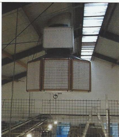
FOTO: VEKO VENTILATIE
